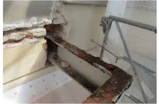
Den frilagda och kraftigt rostkadade balken på den östra balkongen.
