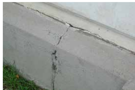
Tornets putsade sockel hade en del sprickor vilka lagades med hydrauliskt kalkbruk. Foto: Spina.
