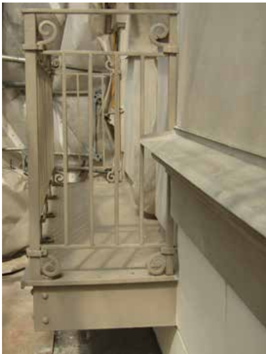
En balkonggavel vid slutbesiktningen.
