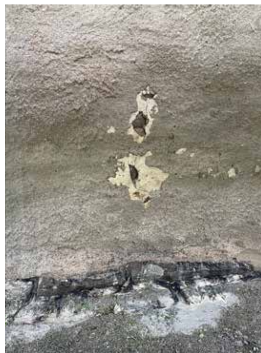
Skadorna vid korets östra fasad var inte så omfattande som man först befarade. Skadorna fanns framförallt i 1990-talets hydrauliska kalkputs. Löst sittande puts knackades ned till fast underlag. Foto: Puts & Tegel.
