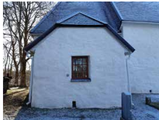
Vid sakristians takfot fanns rötskador, vilka lagades. Foto: Karin Arvidsson.
