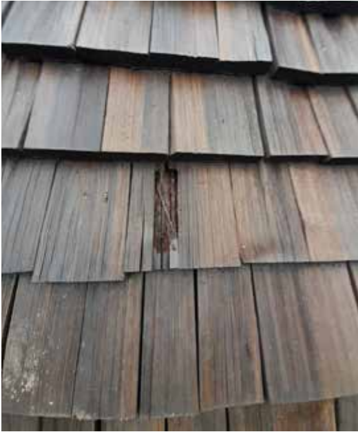
Detalj av befintlig späntäckning på långhusets södra takfall. Det förekom flera rötskador på spånen.
