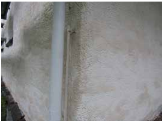
Detalj av långhusets nordvästra hörn efter avfärgning. Fasaderna till vänster är avfärgad med kalkfärgen Vitsjerna och fasaden till höger med KC-färgen Hydarulit.
