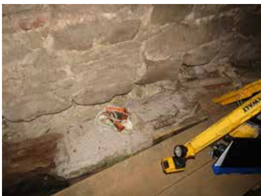
Bindbjälkarna har omfattande skador. På bindbjälken längst mot väster finns en större lagning med cementbruk utförd på 1980-talet.
