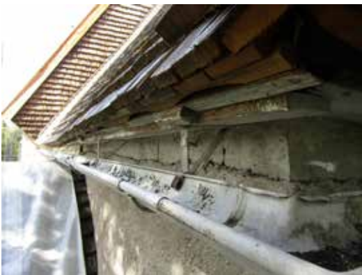
Hängrännan vid korets södra sida. Avståndet mellan taktäckning och ränna var omkring 15 cm. Den smala rännan fångade inte upp det regnvatten som rann från späntaket.
